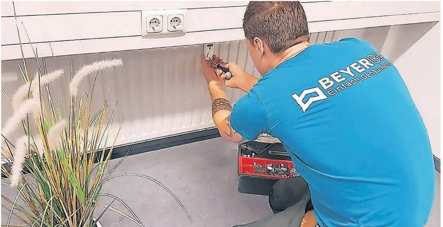
Das Solinger Unternehmen Beyer IBIA stattet die Wohnungen der Kunden mit modernster Messtechnik zur verbrauchsabhängigen Energie- und Wasserabrechnung aus und erstellt die erforderlichen Heiz-, Betriebskosten- und Wärmeabrechnungen. Durch die neue Funktechnik können Ablesetermine vor Ort zukünftig entfallen.
